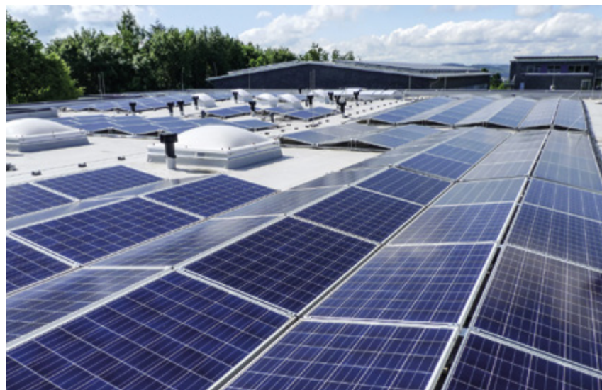
Typische Photovoltaik Eigenverbrauchsanlage auf einem KMU-Gebäude: Ost-West-Ausrichtung zur Vermeidung von Mittagsspitzen
