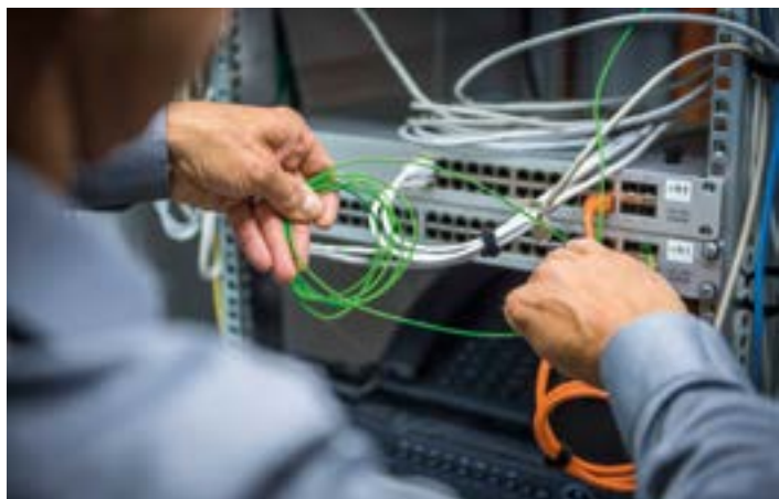
Die Schule Münchwilen ist vollständig mit Breitband-Internet via Glasfaser (grünes Kabel) erschlossen. Bilder: EKT AG
